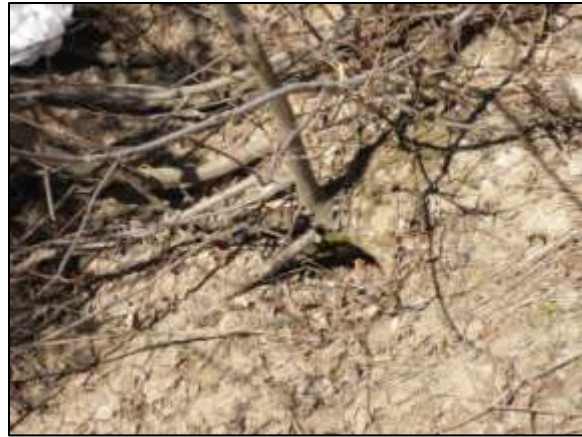
Photo 1 : Accumulation sédimentaire (obstruction) d'un ponceau (n° P4), Route des Lacs, bassin versant du lac Plaisant, Saint-Élie-de-Caxton. © OBVRLY, 2014.
