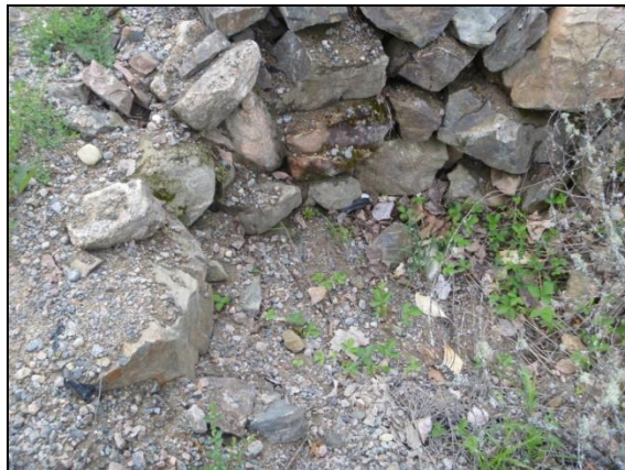
Photo 1 : Accumulation sédimentaire en amont d'un ponceau dont l'entrée est complètement obstruée (Voir ponceau n° P43, carte 2 et annexe 2).
