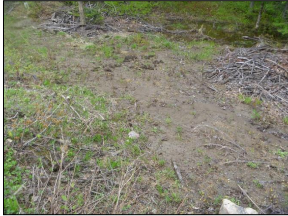
Photo 4 : Accumulation de sédiments sur un terrain privé, Chemin du Grand lac Long (Voir site n° E30 carte 3 et annexe 3).
