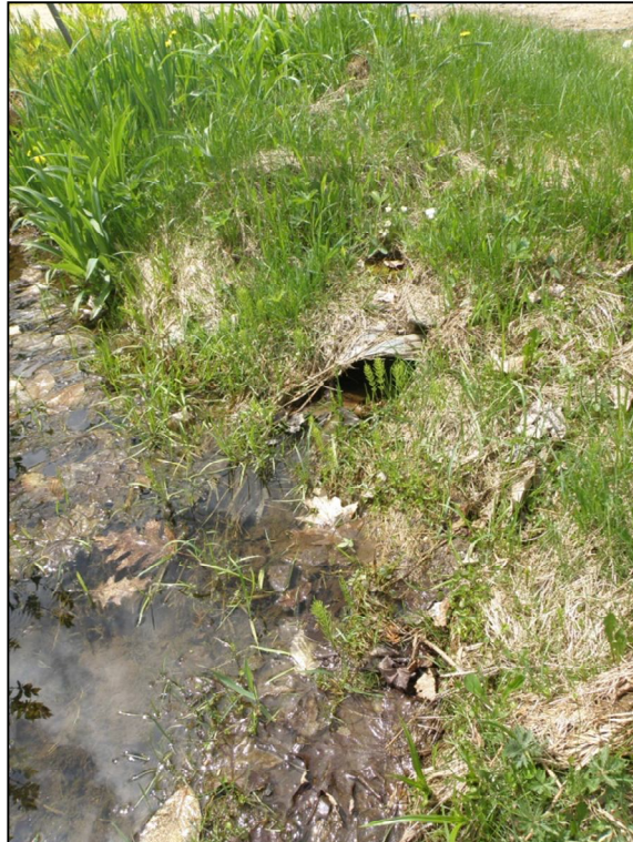
Photo 1 : Ponceau obstrué et non stabilisé à l'entrée et à la sortie (n° P5), chemin du lac-Bell, Saint-Élie-de-Caxton. © OBVRLY, 2015.
