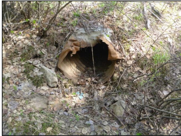
Photo 1 : Ponceau en mauvais état, chemin du lac du Barrage (Voir ponceau n° P7, carte 2 et annexe 1).
