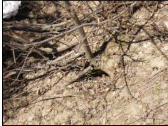
Photo 1 : Accumulation sédimentaire (obstruction) d'un ponceau (n° P4), Route des Lacs, bassin versant du lac Plaisant, Saint-Élie-de-Caxton. © OBVRLY, 2014.
