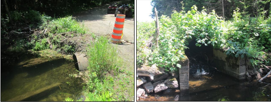
Photos 5 et 6 : Le ponceau n° PERM-33 est situé à Saint-Alexis-des-Monts et traverse l'exutoire du lac Lavallée (carte 3).
