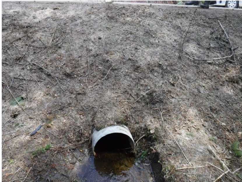
Figure 1 : Ponceau très détérioré (site P02) à Saint-Alexis-des-Monts en 2019
